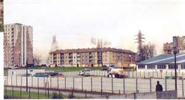
Destruction de la tour 26 rue Miellet
